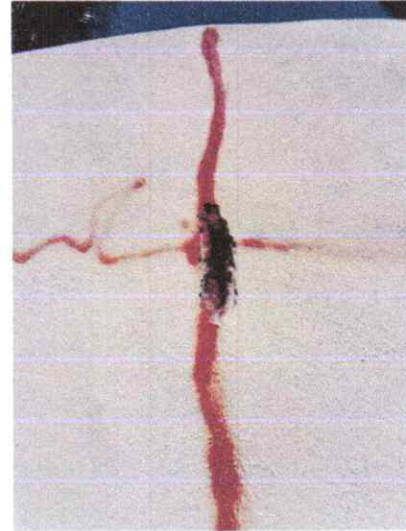
Falla al exterior
