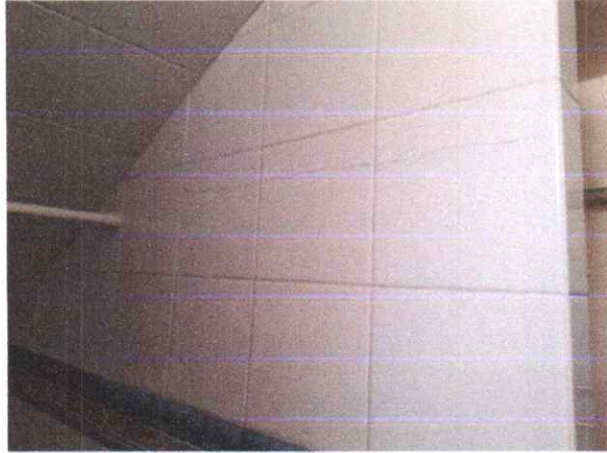
Grietas en azulejo (área de regadera)
