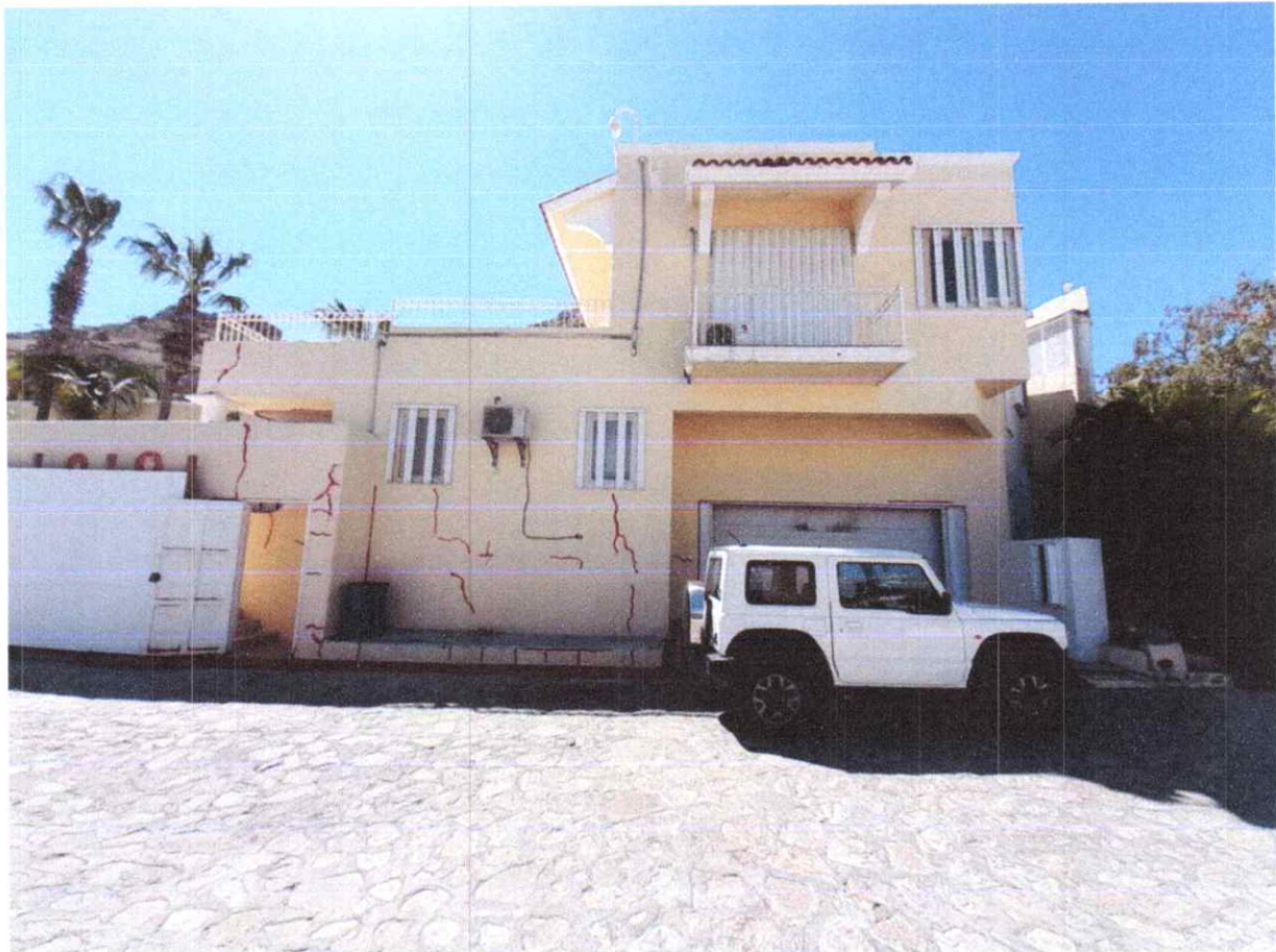
Grieta en muros Fachada lateral Callejón del Pueblo
