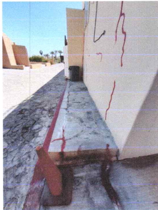
Grieta en banqueta exterior Callejón del Pueblo
